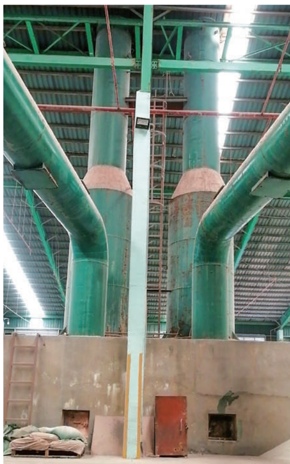
Hệ thống xử lý bụi tại Nhà máy sản xuất phân bón NPK KCN Long Mỹ
